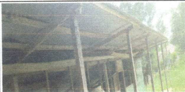
Foto 1: Se observa el deterioro de madera en la galera donde se recibe clases
