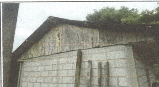
Foto 3: Se observa que una bodega es la direccion del Instituto en mal estado
