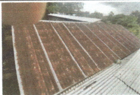
Foto 5: Se observa las laminas portantes de las aulas, en mal estado.
